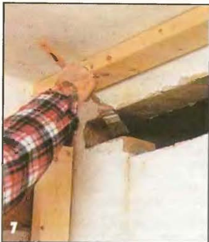
Удалив еще один ряд кирпичей ниже базового, поверхности кладки очищают от остатков старого раствора и строительной пыли.
