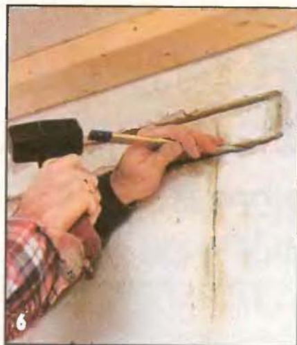
Продрав сквозные отверстия в перегородке по периметру верхнего базового ряда кирпичей, удаляют узким зубилом перемычки из штукатурного раствора между этими отверстиями.
